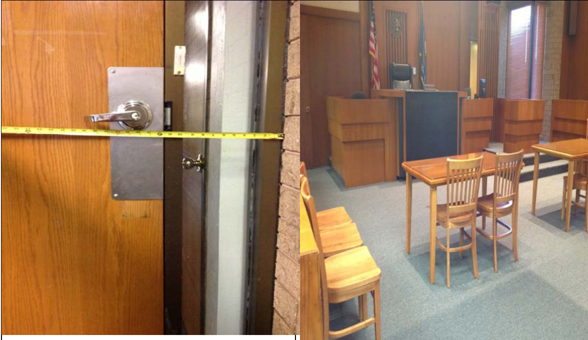
1. No door maneuvering clearance
